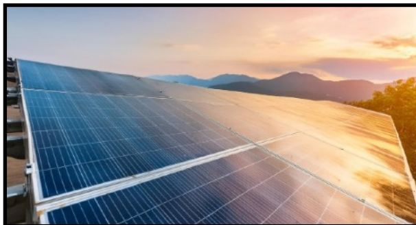
Figura No. 2.1 Paneles solares que absorben la luz solar.
