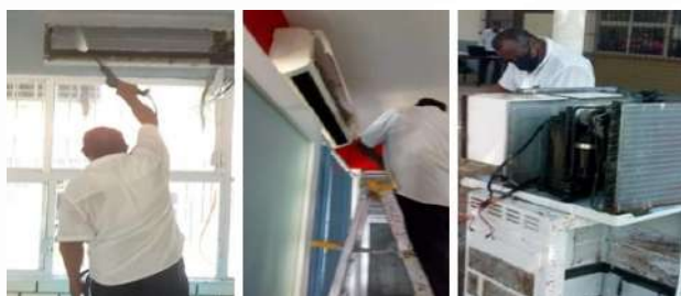
Acciones de mantenimiento de aires acondicionados.
